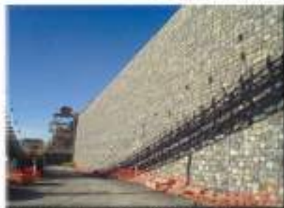
Chancadora Primaria Mina GoldFields - Cajamarca
